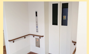
● エレベーター
