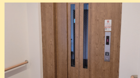
● エレベーター
