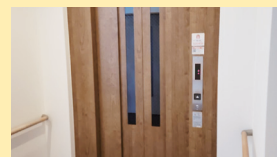
● エレベーター
