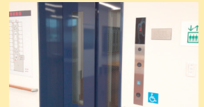
● エレベーター
